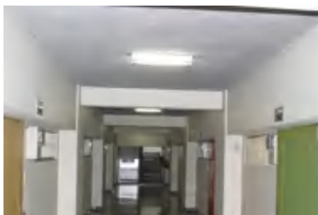
写真 4：吹付けアスベスト(クリソタイル)
