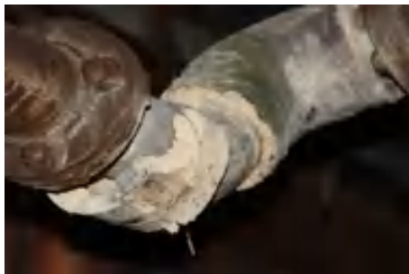
写真 15：劣化した配管保温材
