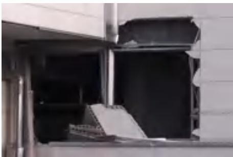
写真 21：津波で被災した押出成形板
