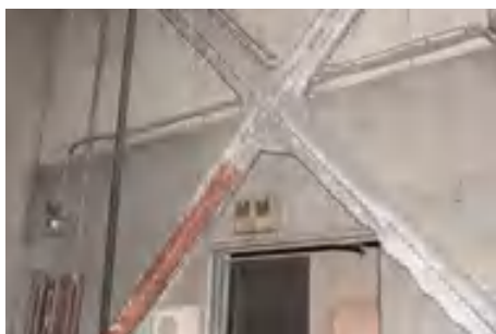
写真 2：吹付けアスベスト(クリソタイル)
