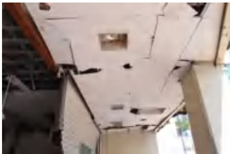
写真 24：被災した軒天のけい酸カルシウム板
