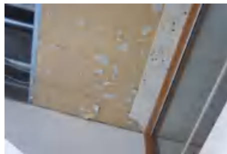
写真 28：水害で被災したロックウール天井
