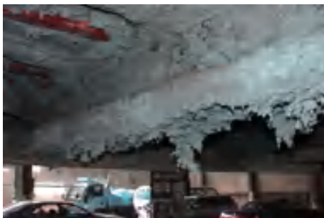
写真 1：吹付けアスベスト(クロシドライト)
