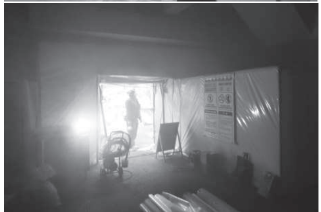
（▲養生からの漏れの写真）
